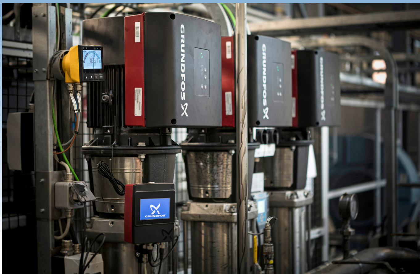
格兰富 CRE 泵和监控装置在 BIRN CED 喷涂和表面处理设备中的喷涂罐上运行。
