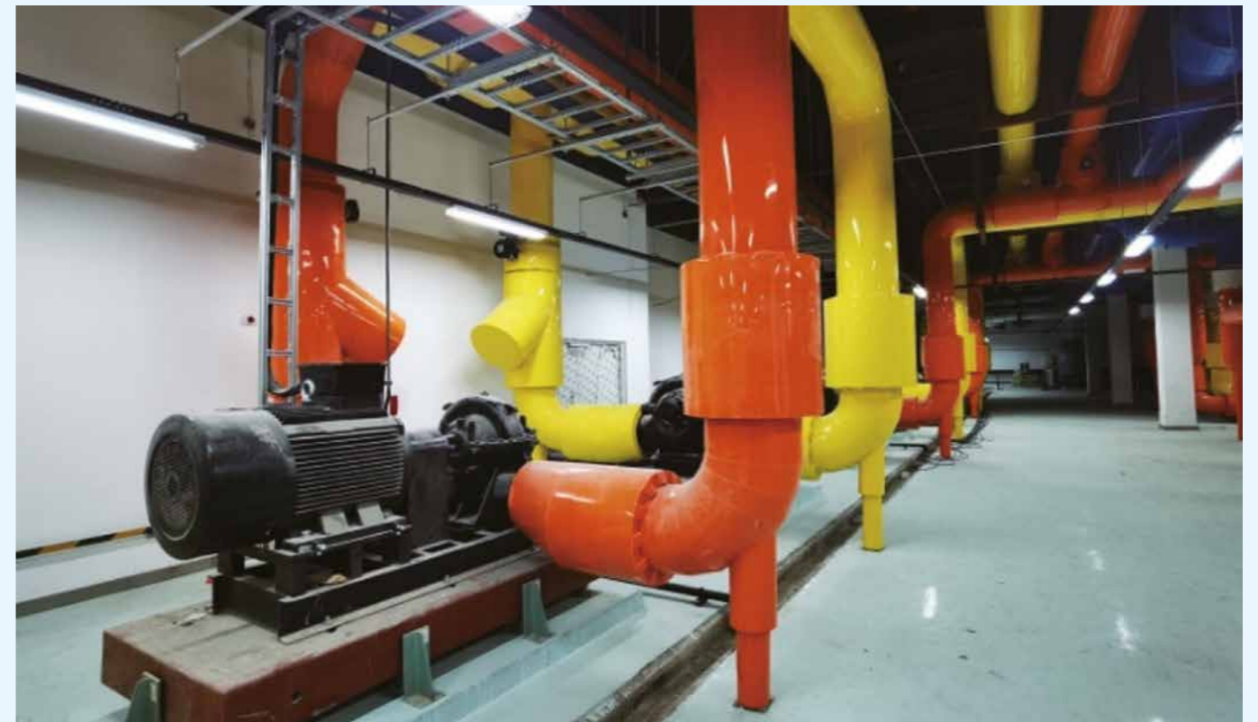
山东某数据中心项目
